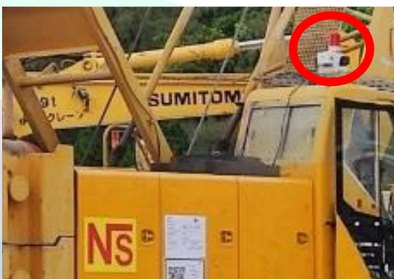
Unsafe Acts / Dangerous Situation Alert within Mobile Plant Operation Danger Zone 移動設備操作區域的 不安全行為 / 危險情況警報
